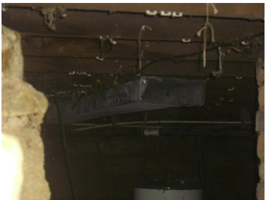
Duct No Wrap
